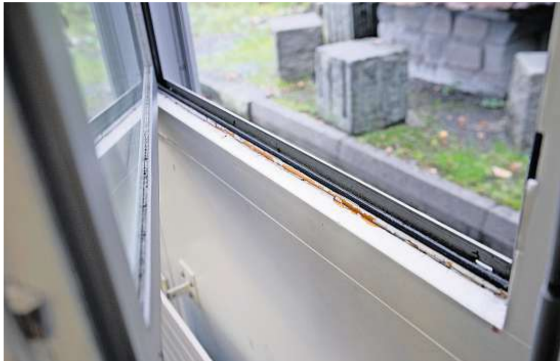
Undichte Fenster lassen Feuchtigkeit und Nässe in die Schulräume eindringen. Der geplante Neubau soll in Minergiestandard erstellt werden.
